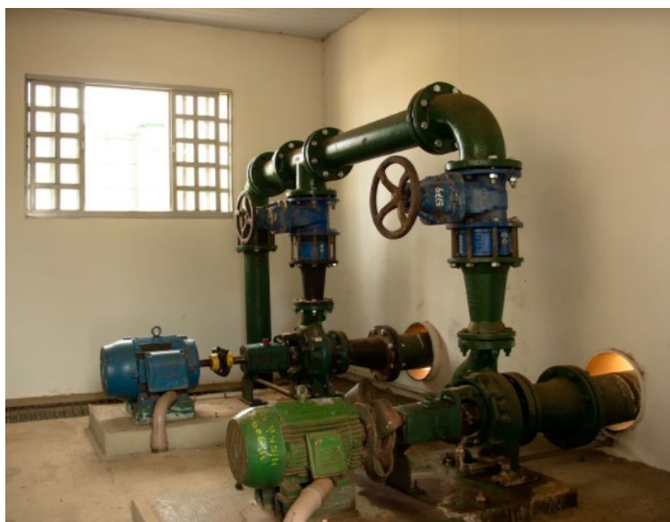
Figura 20 - Conjunto motobomba utilizada no SAA.
