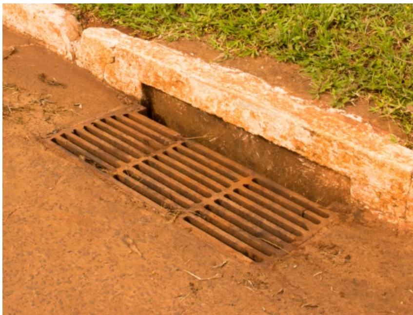
Figura 28 - Boca de lobo (simples) localizadas em Antônio João, MS.
