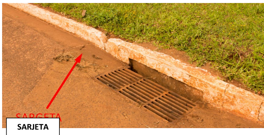
Figura 27 - Sarjeta para facilitar o escoamento da água superficial.
